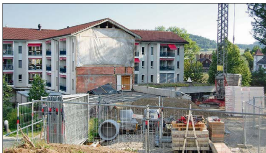
Beim Betagtenzentrum Linde wird schon fleissig gebaut. Die ehemalige Heimleiterwohnung ist bereits abgebrochen, und an ihrer Stelle werden nun die Erweiterungsbauten erstellt. Foto Willi Röllli
